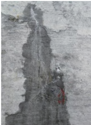
图 4 温度缝实景图二
