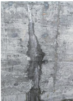
图 3 温度缝实景图一
