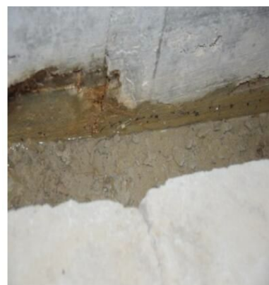
图5 蜂窝麻面并伴随渗漏水
