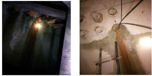
图3 穿线套管渗漏水
