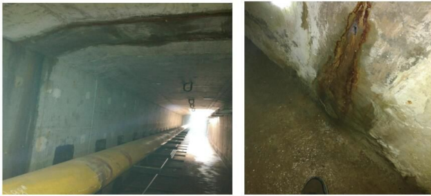
图1 结构缝渗漏水情况
